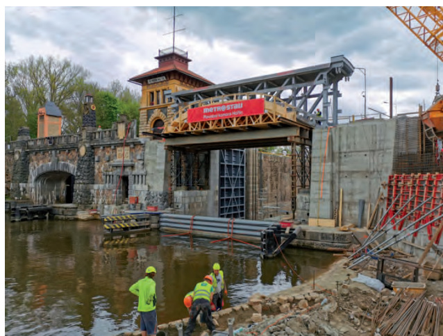
Montáž mostovky přes velkou plavební komoru a zednické práce na dolní rejdě
