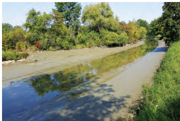
Úsek Baťova kanálu před opravami a vyčištěním
