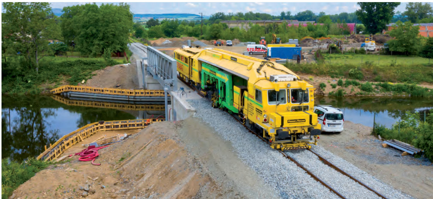
Úprava kolejového lože pomocí ASP 09-16/4S na novém železničním mostě v Lužci nad Vltavou
