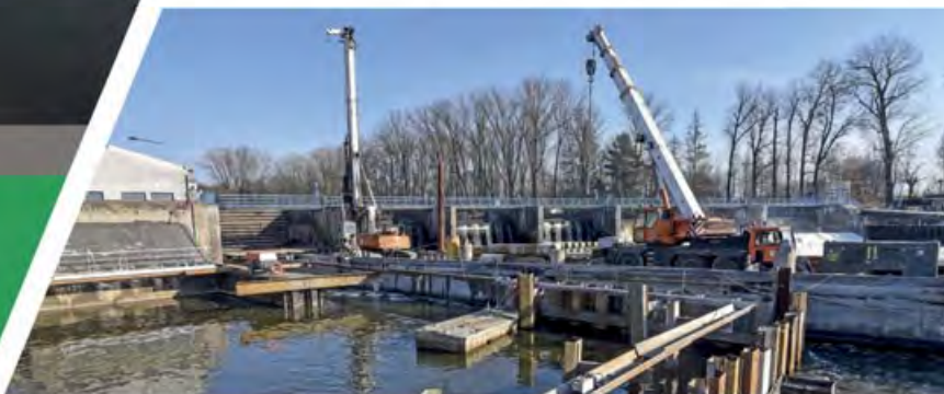
Malá vodní elektrárna na jezu Veletov na Labi
