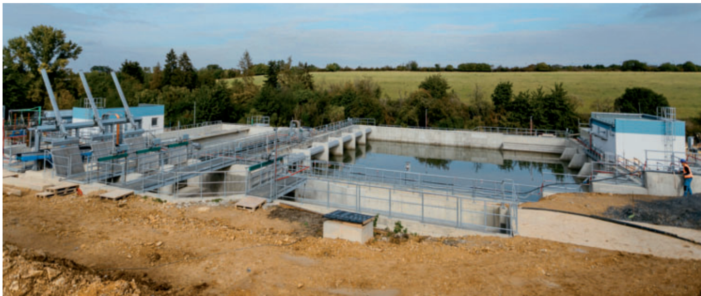
Část mechanického předčištění (měrný objekt), objekt odlehčení s korytem, lapák štěrku a usazovací nádrže, dále pak retenční nádrž a sorpční filtr, technologie hrubého a mechanického předčištění a další retenční nádrže
