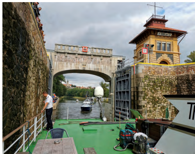
Rozšířené dolní ohlavi PK Hořín a mostovka ve zdvižené poloze
