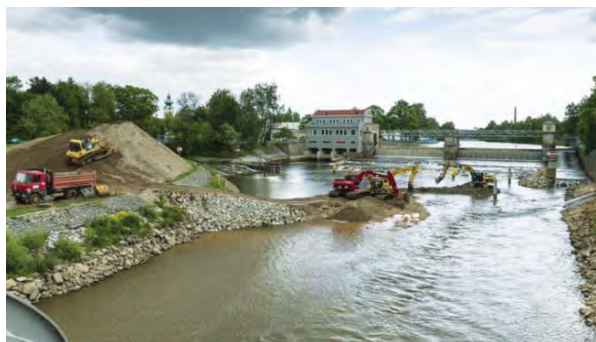
Výstavba obratiště v podjezí Jiráskova jezu v Českých Budějovicích byla velmi náročná
