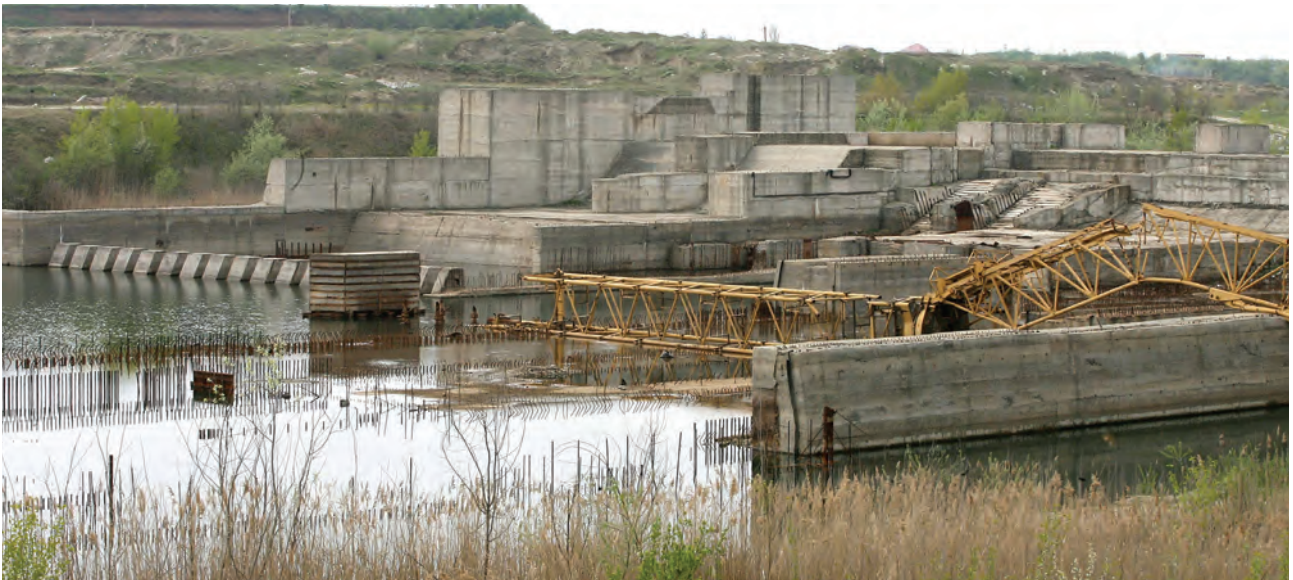
Na staveništi zůstaly stroje a veškeré vybavení – co se dalo bylo rozkradeno
