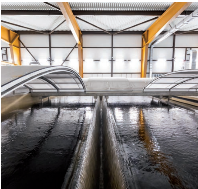
Hala GAU, 2NP, pohled na otevřený filtr – praní filtrační náplně vodou
