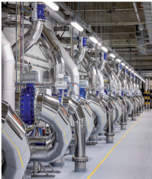
Hala GAU, 1. NP, armaturní sál
