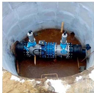
Pohled do šachty s automatickými vzdušňáky.
