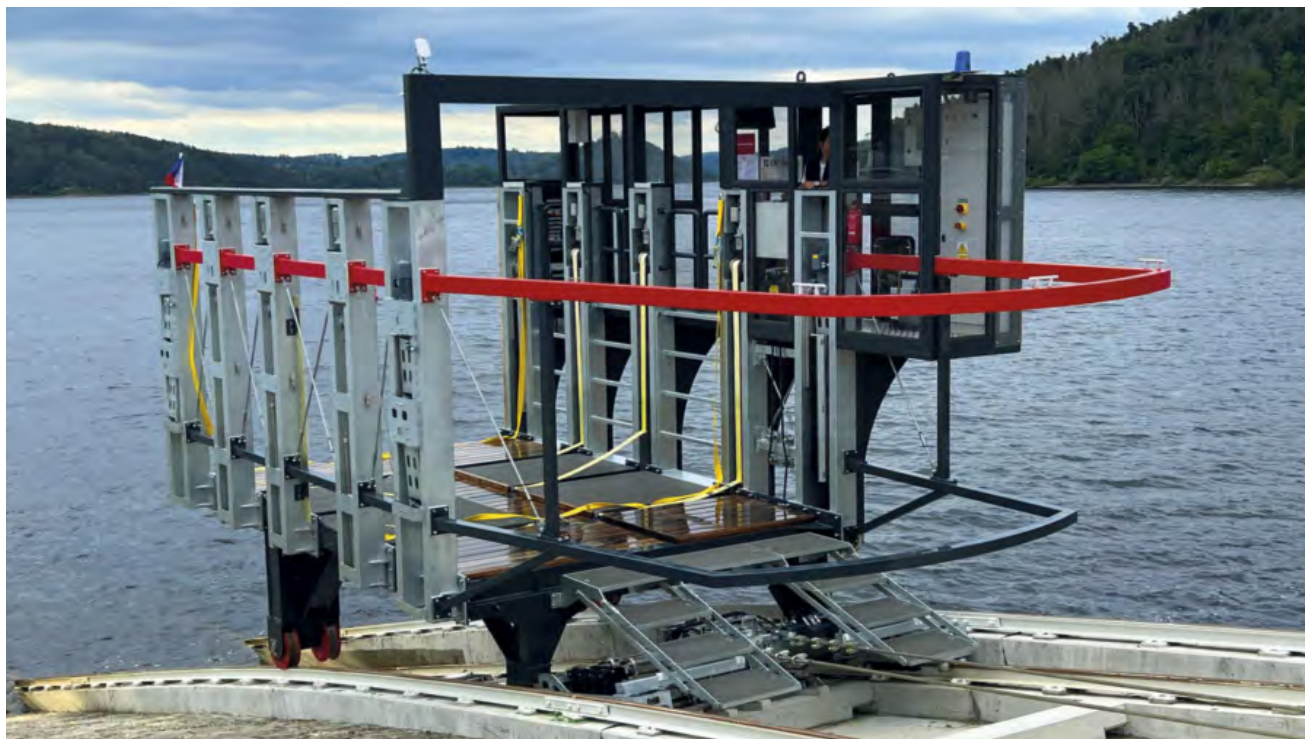
Výtah na horní vodě, 27. května 2022
