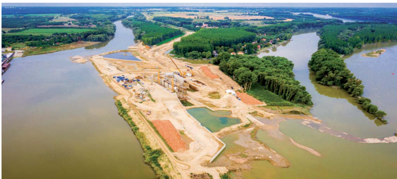
Celkový pohled na staveniště nového jezu a plavební komory na soutoku Mošonského Dunaje s Dunajem
