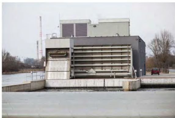
12 Vodní elektrárna Liběchov, 2015
