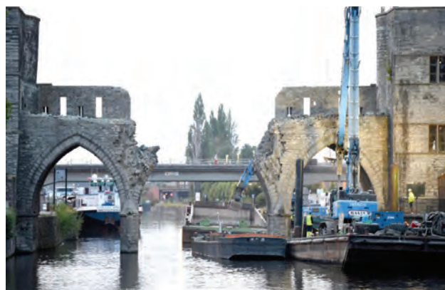
V roce 2019 byla zahájena přestavba mostu, která si nejprve vyžádala demolicí střední části mostu
