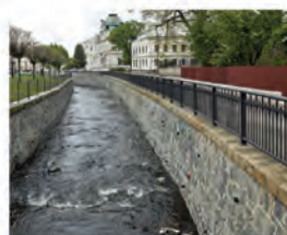
Odstranění povodňových škod, Česká Kamenice
