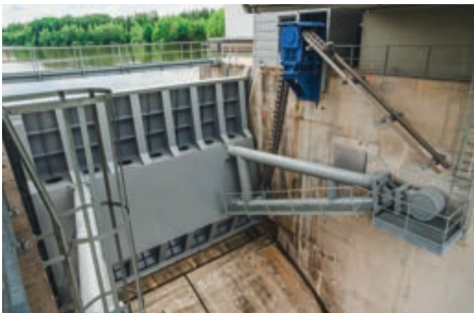
Pohled na jeden ze dvou nových segmentů bezpečnostního přelivu. Zdroj: Metrostav a.s.
