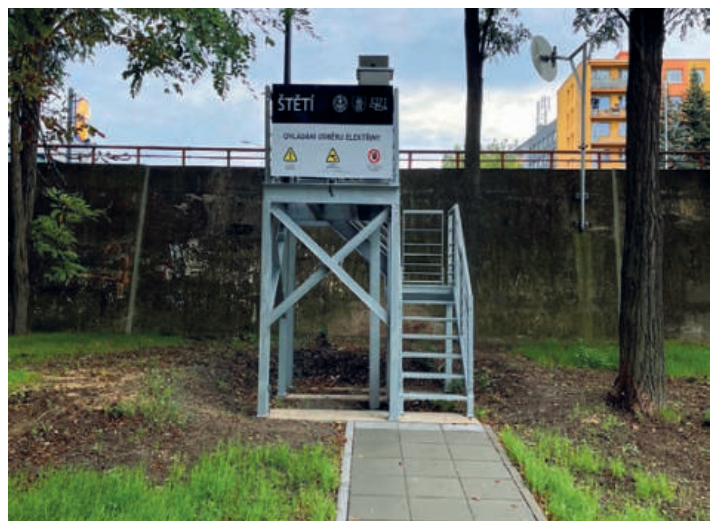
Přístaviště Štětí – rozvaděčové plato pro ovládání odběru elektřiny
