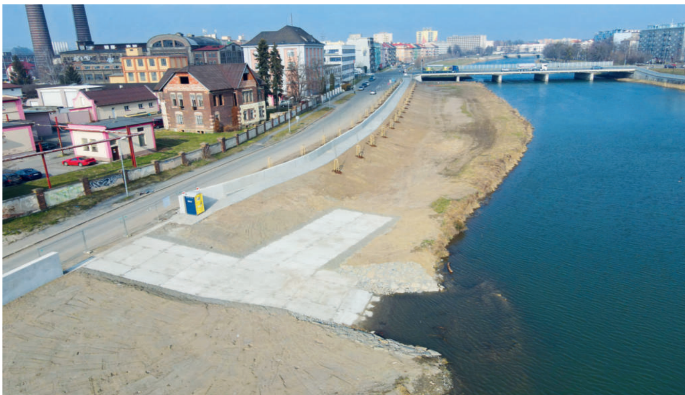
Pohled na část dokončené zdi na objektu SO 03.1 - ochrannou stěnu mezi mosty včetně nového sjezdu do Bečvy sloužícímu pro HZS a Povodí
