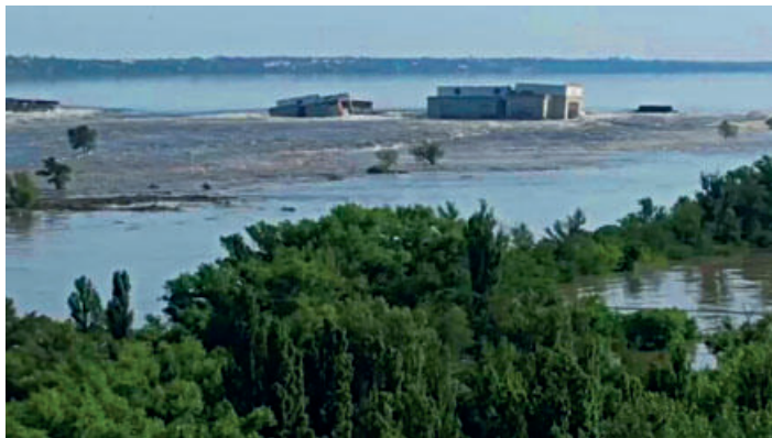
Celkový pohled na hlavní objekty přehrady Nova Kachovka krátce po jejím protržení
