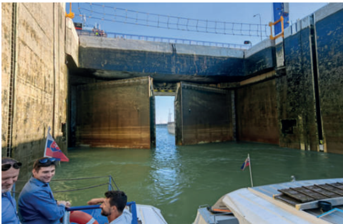
Pravá PK - zatváranie dolných vrát
