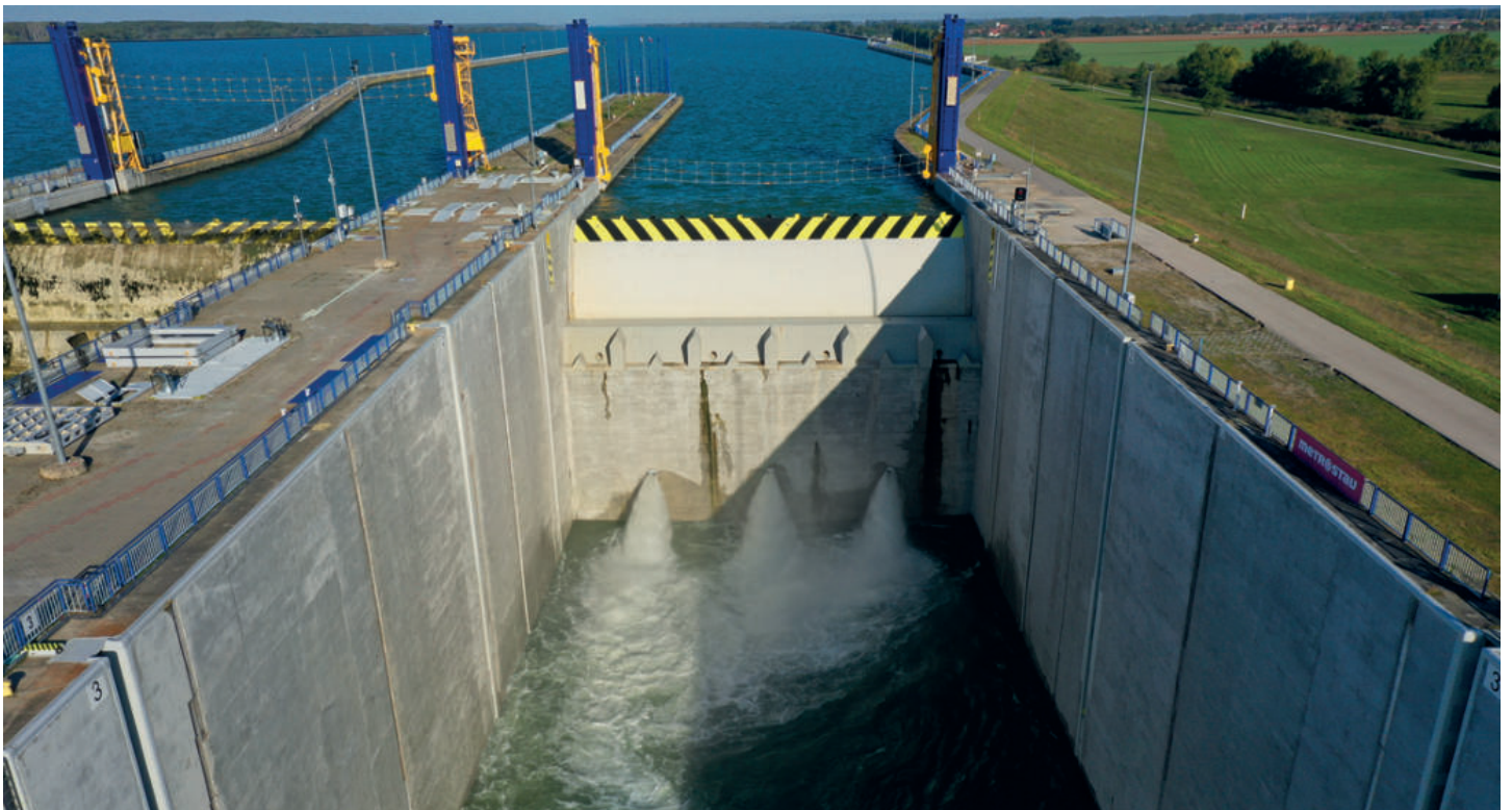
Zatápění komory pomocí šoupátek DN600
