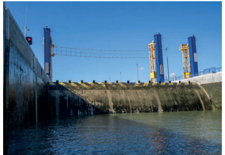
Preplavenie pravou PK po prúde
